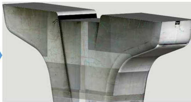
ひび割れ3次元鳥瞰図
