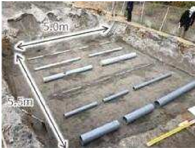
〈GL-1.0mにおける埋設管状況 (実験フィールド)〉
