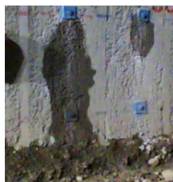
写真-6 二次吹付けの漏水・しみ
